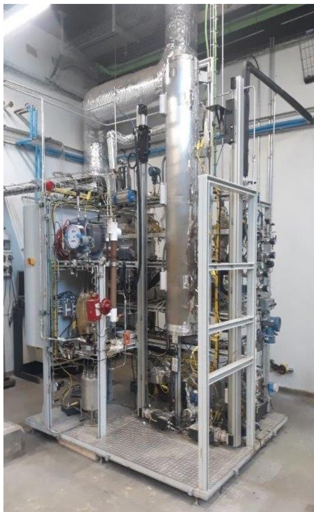
Planta piloto de coquización
